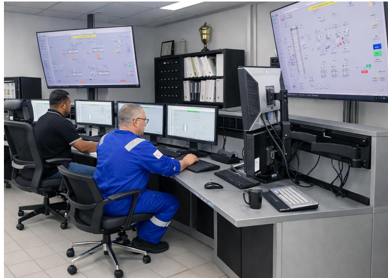
AUTOMATIZACIÓN Y CONTROL
